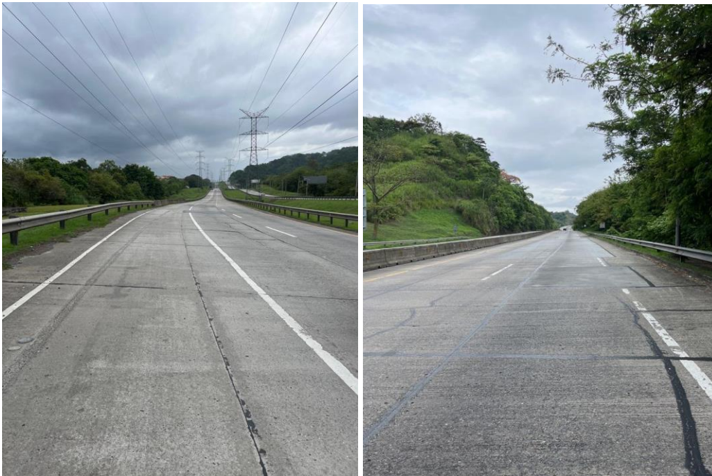
Daños en áreas aledañas a zonas con reposición de losas
