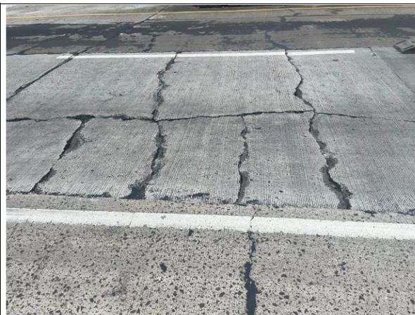
Parámetro de losas para ser atendidas por reposición total, presencia de grietas múltiples en una losa.
