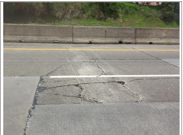
Parámetro de losas para ser atendidas por reposición total presencia de oquedades y agrietamiento.
