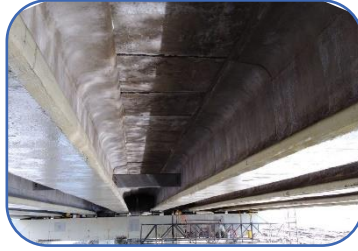
Condición final de las vigas cabeceras
