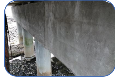
Condición final de lo trabes
