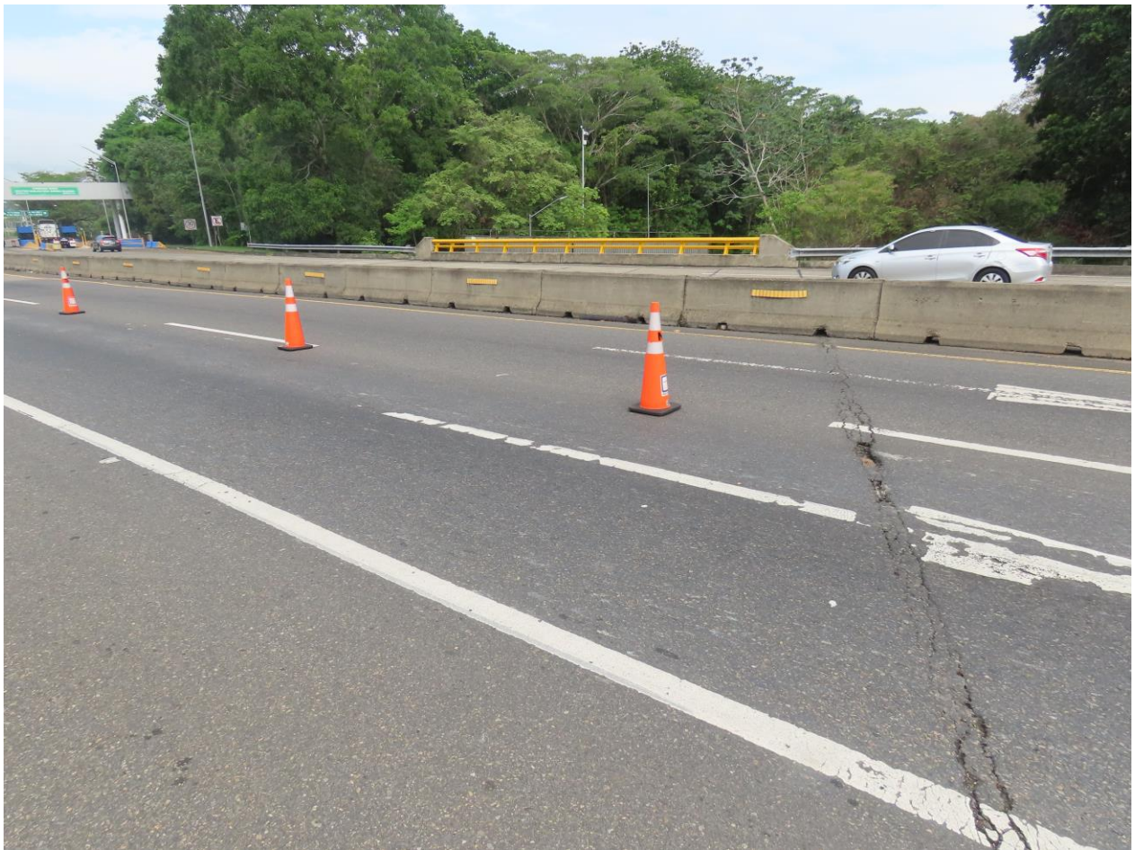
Ilustración 8 - Estado de Juntas de Expansión en Carriles Vía El Dorado.
