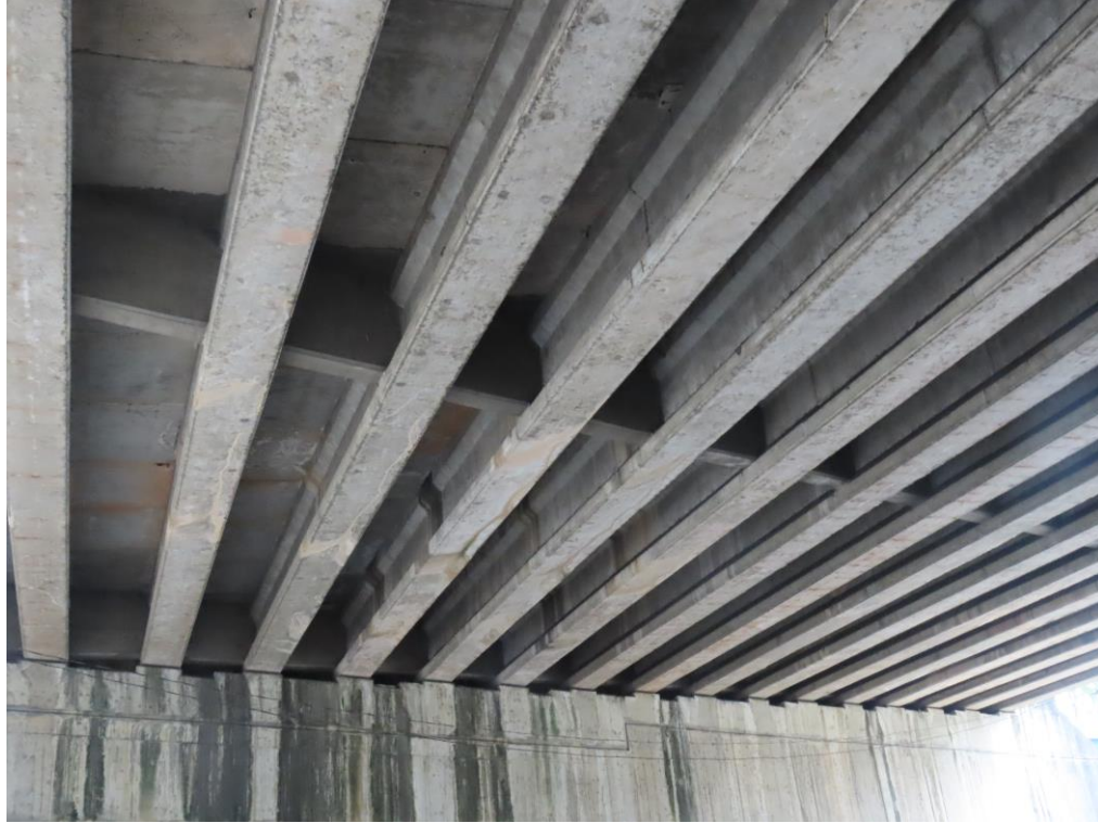
Ilustración 3 - Estado Actual de Losetas Prefabricadas en Carriles Vía Albrook
