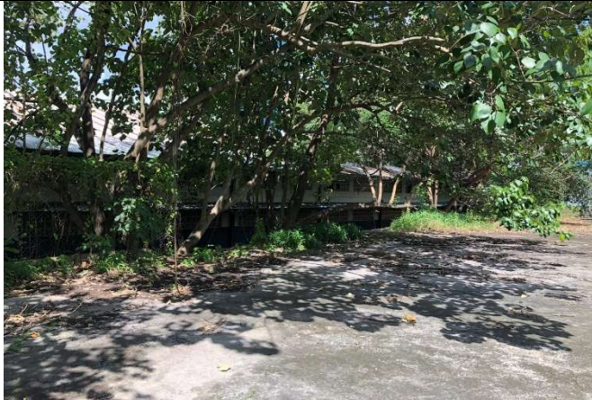
Aspecto de final de cerca de malla de ciclón. Se ve el deterioro y vandalización de esta.
