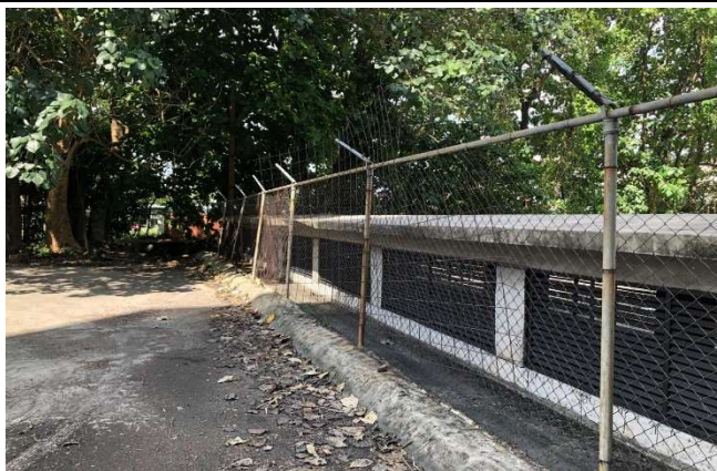
Aspecto de cerca de malla de ciclón frontal. Se ve el deterioro y vandalización de esta.
