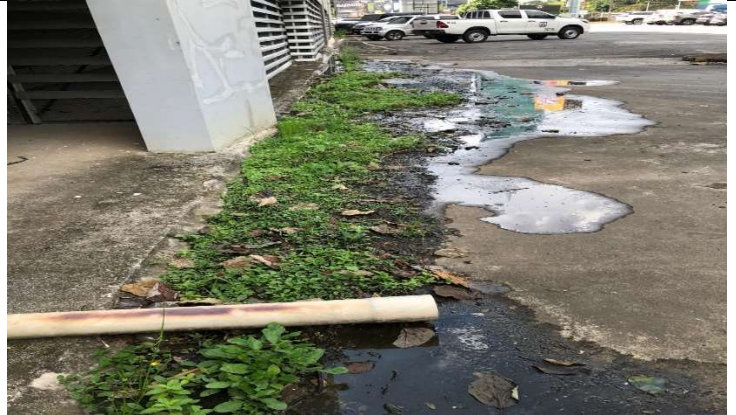
Descarga de aguas por parte de propiedad privada colindante, a servidumbre del Corredor Sur.
