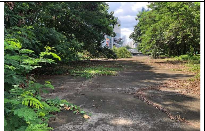
Aspecto de una sección de parte superior de túnel. Exceso de follaje.
