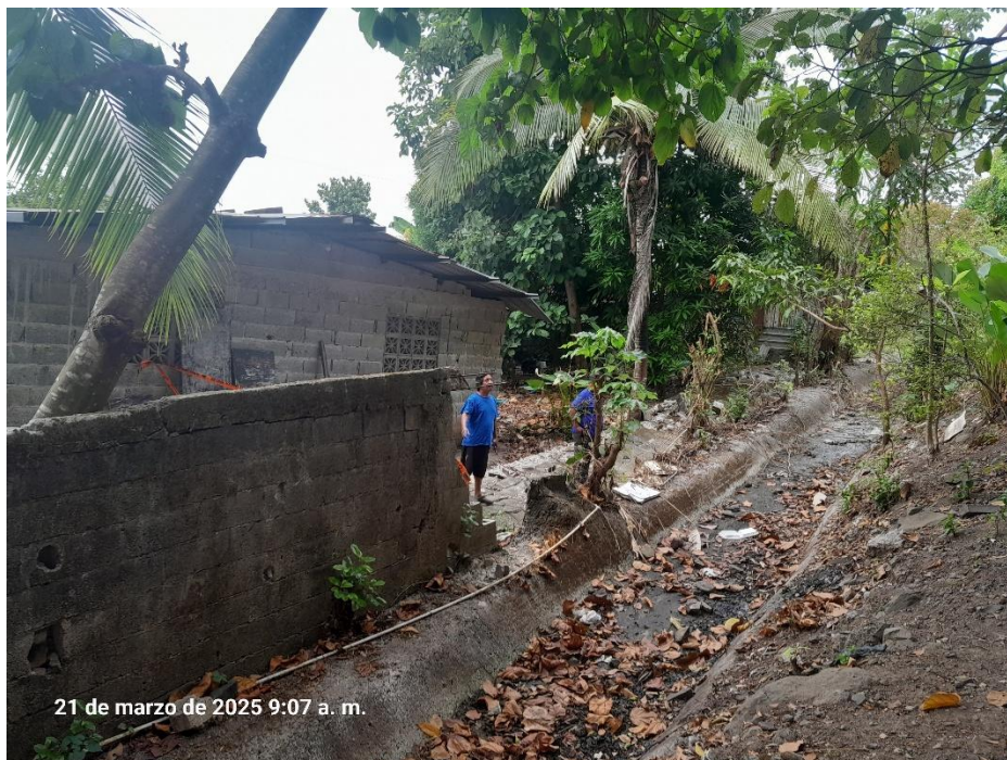
Vista de los tramos colapsados entre 2 residencias.
