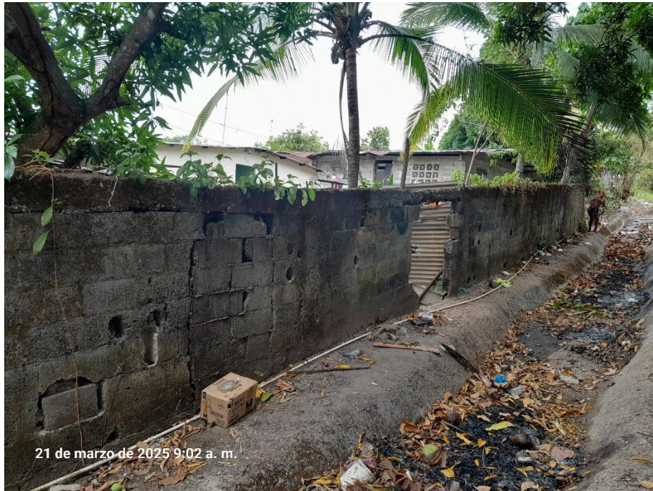
Parte de tramo posiblemente inestable, el cual se recomienda demoler y reconstruir.
