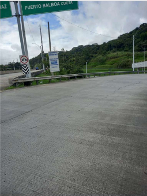
Foto N°5: Se evidencia fisura longitudinal producida por desplazamiento del suelo en el eje hacia Albrook del intercambiador Lajas
