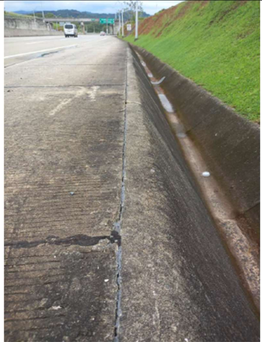
Foto N°2: En esta imagen se evidencia altos niveles de oxidación en el material asfáltico 21K+550
