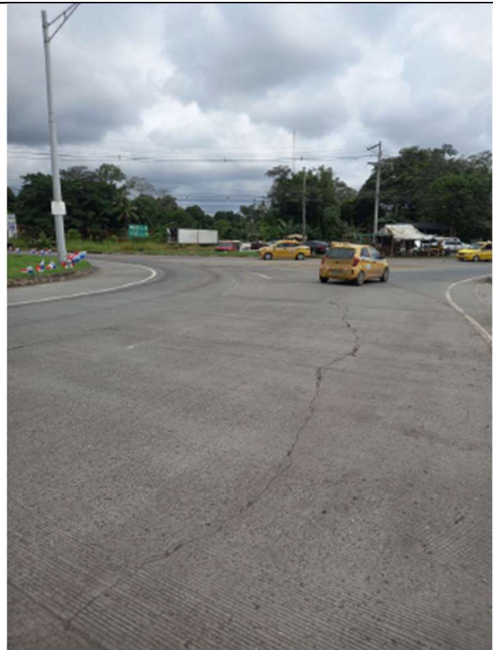
Foto N°4: Se evidencia fisura del pavimento rígido en la rotonda de Villalobos
