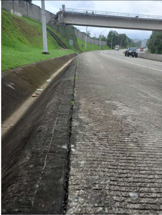
Foto N°1: Se evidencia el deterioro del sellador asfáltico Kilómetro 21K+525
