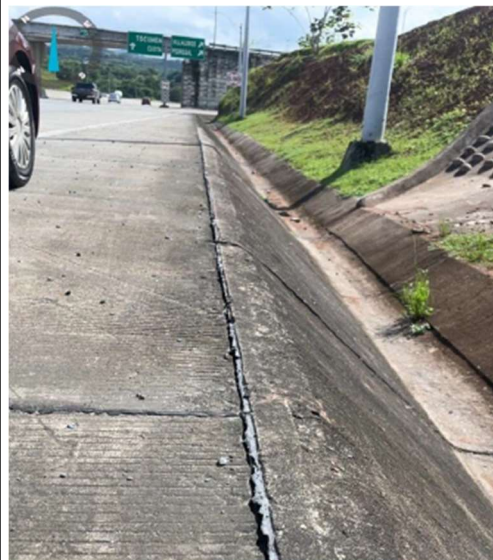
Foto N°8: Se evidencia desplazamiento entre la junta de la cuneta pavimentada tipo trapezoidal y la losa de concreto.
