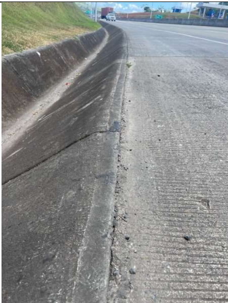
Foto N°7: Se evidencia deterioro del sello de junta en el Kilómetro 21+600 con sentido a Albrook
