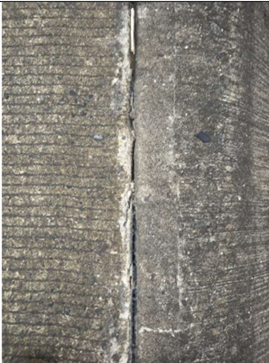
Foto N°3: En la imagen se evidencia el deterioro del sello de junta en el Kilómetro 21 con sentido a Albrook
