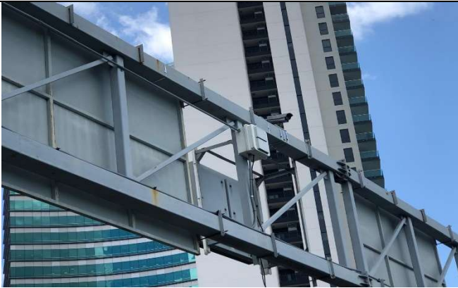
Se presenta evidencia de manchas y trazos de óxido a lo largo de los elementos verticales y horizontales del pórtico.
