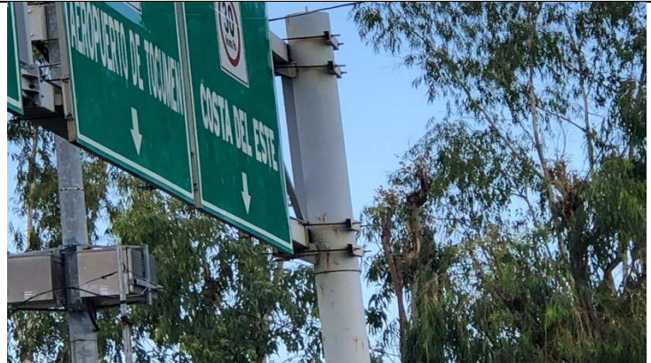
Se presenta evidencia de manchas y trazos de óxido a lo largo de los elementos verticales y horizontales del pórtico. Se evidencia óxido en elementos de pernos.
