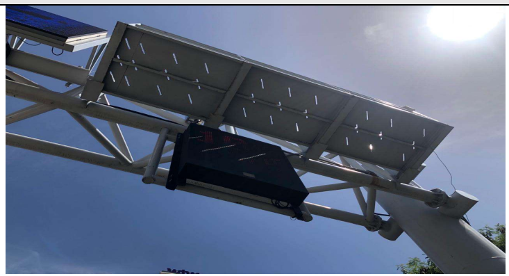
Se presenta evidencia de manchas y trazos de suciedad con moho a lo largo de los elementos del pórtico.
