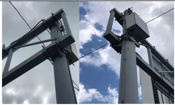
Se presenta evidencia de manchas de óxido a lo largo de los elementos del pórtico.
