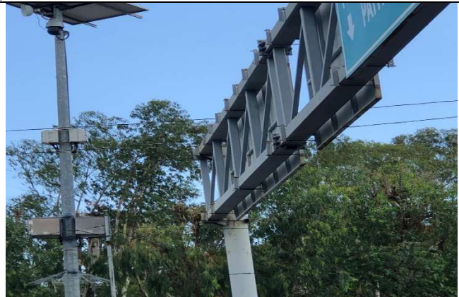
Se presenta evidencia de manchas y trazos de óxido a lo largo de los elementos del pórtico.
