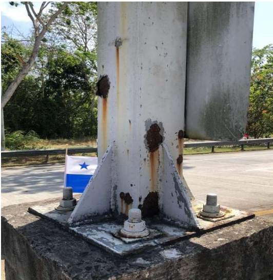
Se presenta evidencia de oxidación a lo largo de los elementos verticales y horizontales metálicos de la bandera.
