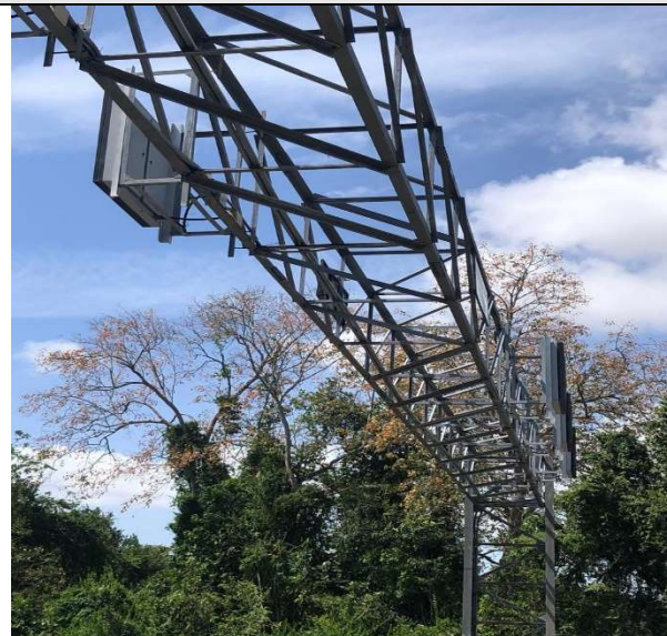
Se evidencia el estado del pórtico, el cual solo necesita limpieza. Muchos de los tornillos de los pernos que sujetan los aparatos en la foto, presentan oxidación.
