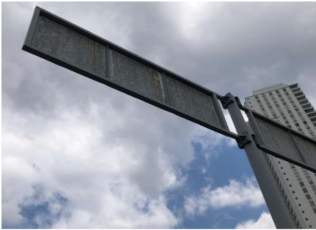
Se evidencia el estado del cuadro metálico de la señalización, el cual tiene evidencia de oxidación leve.
