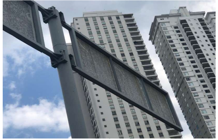
Se evidencia el estado del cuadro metálico de la señalización, el cual tiene evidencia de oxidación leve.
