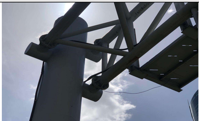
Se presenta evidencia de manchas y trazos de suciedad y moho a lo largo de los elementos verticales con horizontales del pórtico.
