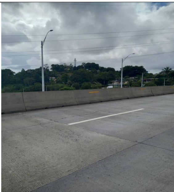
Foto N°3: Falla en bloque de pavimento rígido en intercambiador vial 19k+600, losa de 5.60 x 4 m
