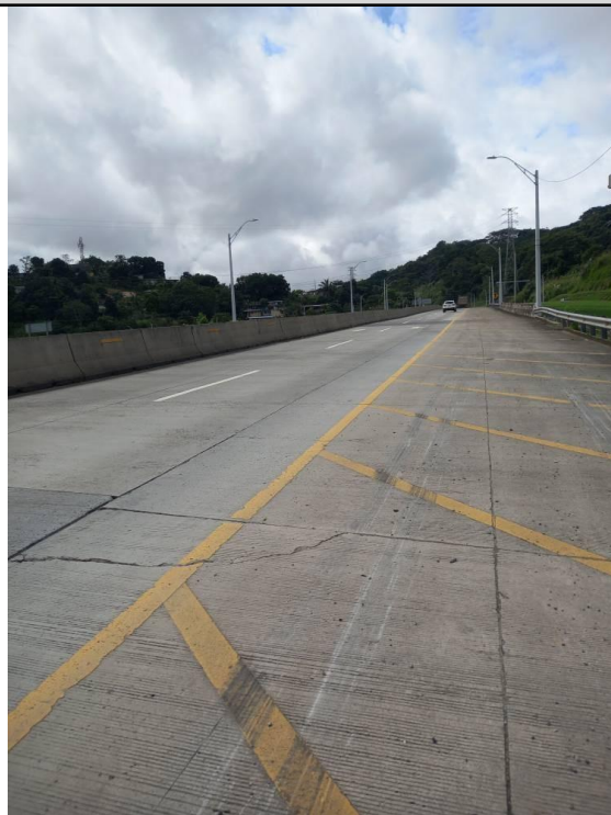
Foto N°2: Falla de pavimento rígido en el intercambiador vial Brisas del Golf
