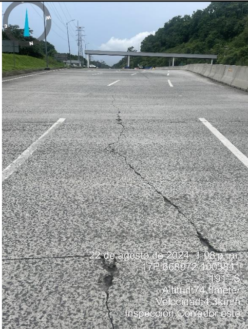
Foto N°9: Vista de losas fracturadas y con desnivel. Brisas del Golf @ Brisas Norte
