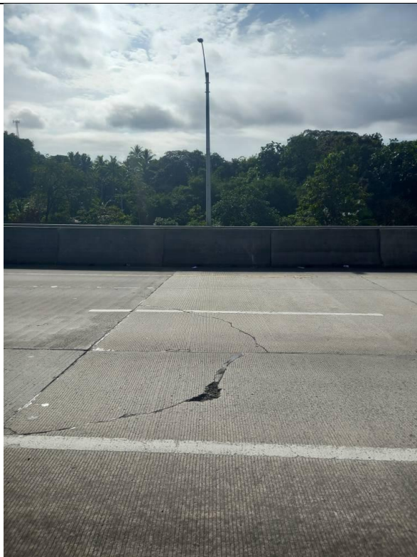
Foto N°5: Vista de lasas fracturadas y con desnivel 2 lasas. 22k+500 Panamericana @Albrook
