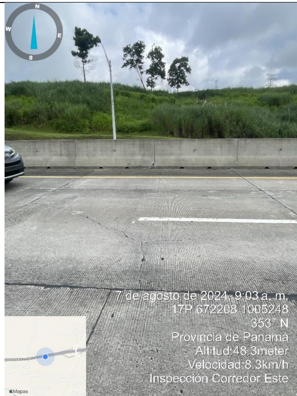
Foto N°6: Vista de lasas fracturadas y con desnivel 1 losa. 23k+400 Albrook @ Panamericana
