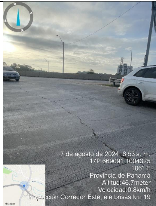
Foto N°12: Vista Sentido Brisas Norte @ Corredor, pavimento rígido fracturado
