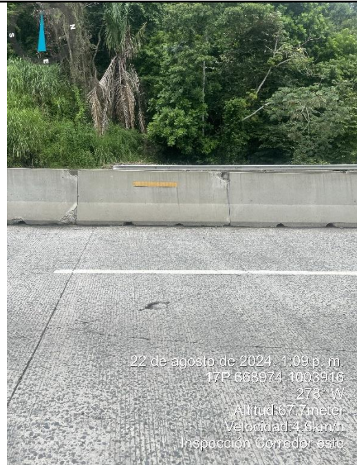
Foto N°10: Vista de losas fracturadas y con desnivel. 19k+600 Albbrook @ Panamericana
