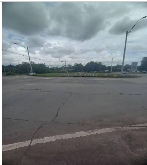
Foto N°4: Falla en bloque de pavimento rígido en rotonda Villalobos 21k+700 2 losas afectadas
