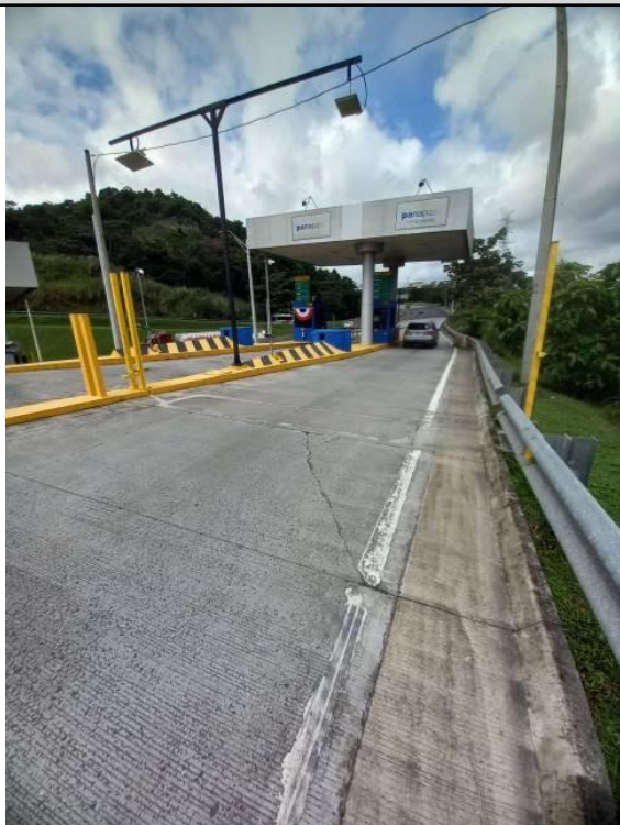
Foto N°1: Vista Sentido Brisas Norte @ Corredor, pavimento rígido fracturado
