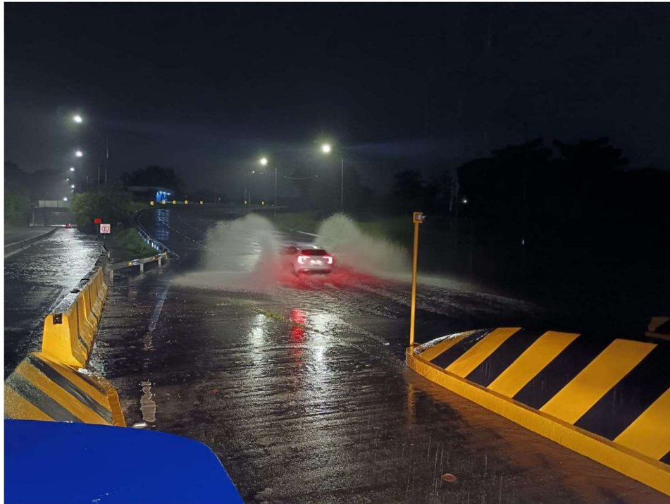
Imagen 1: Zona de acumulación de agua.
